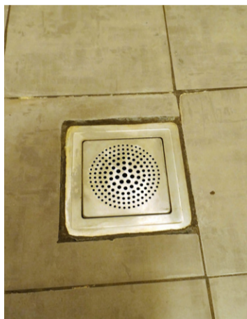
Igenproppade golvbrunnar kan vara svåra att få rena på traditionellt vis.
